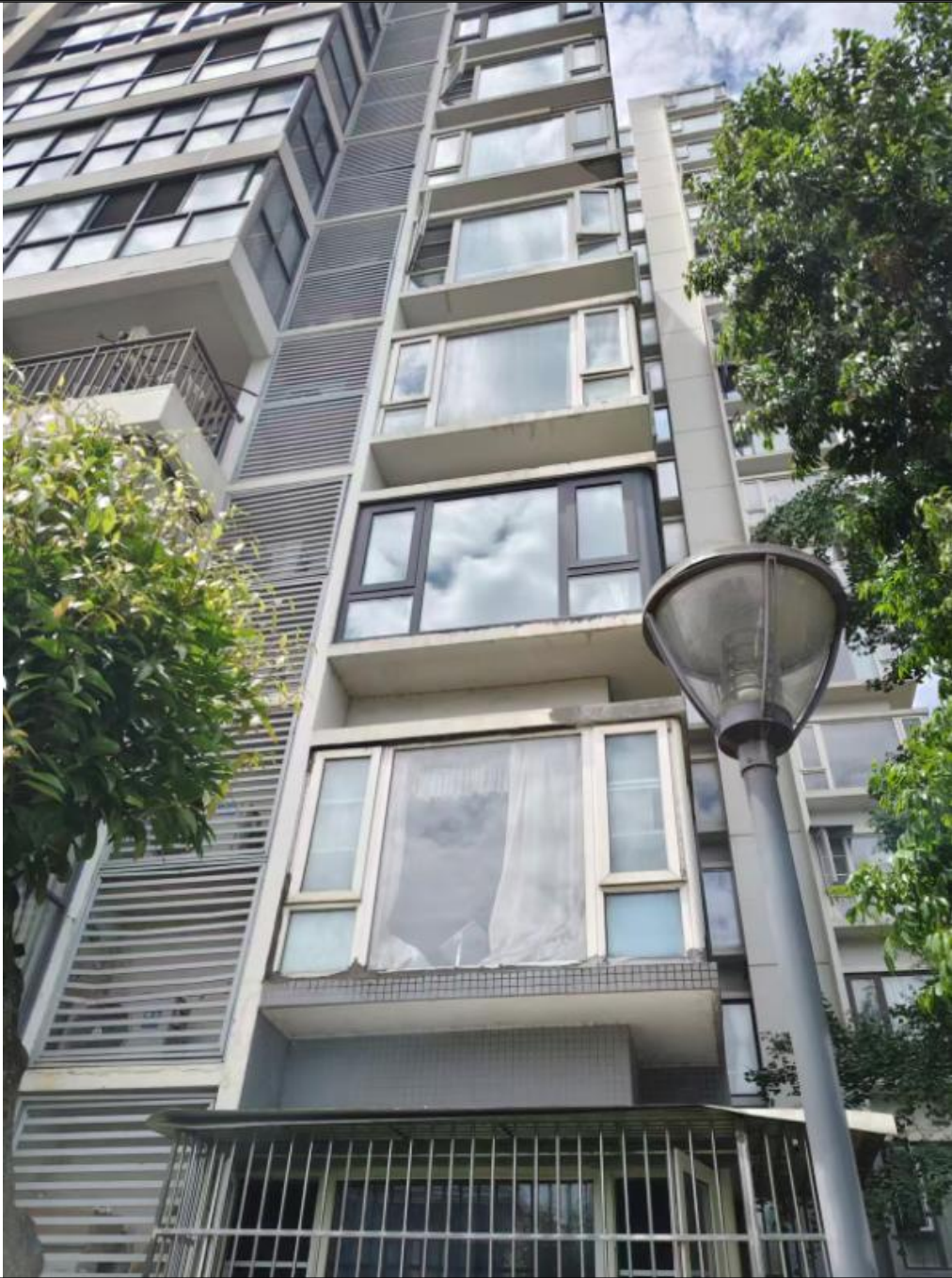
清水路苑一组团 46 幢居民房未安装隔声窗
