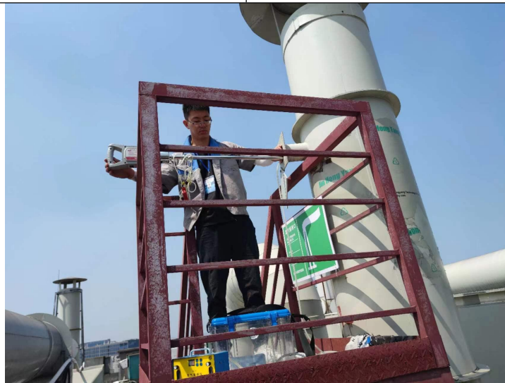
本项目废气排气筒
