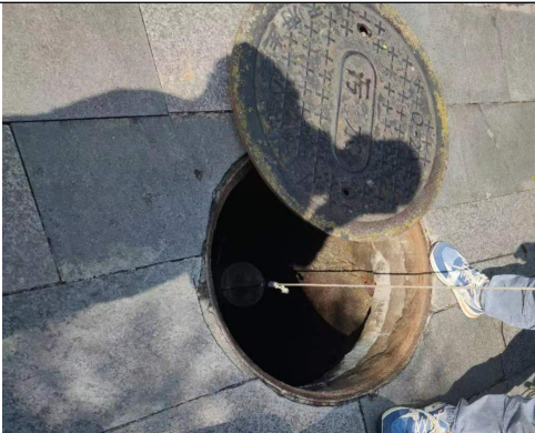
依托园区化粪池
